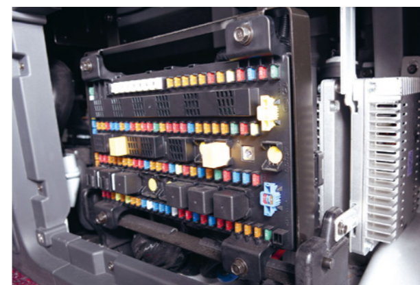
Блок предохранителей (расположен в районе передней двери)
